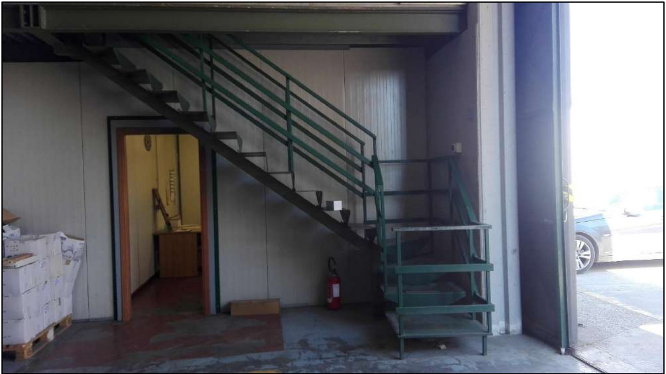
Figura 7: Dettaglio scala in metallo che conduce alla zona uffici e amministrazione al Piano 1
